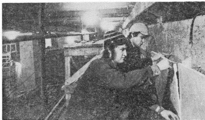
Отделочные работы на станции «Ботанический сад». Облицовку путевой стены ведут В. Аносов (слева) и А. Мишин.
