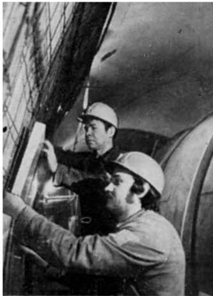
Облицовку путевых стен ведут бригадир УСР К. Слонов и отделочник В. Гончаров.
